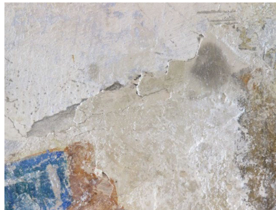
Fig. 17. Sydvæg, op- og afskallet malepuds.
