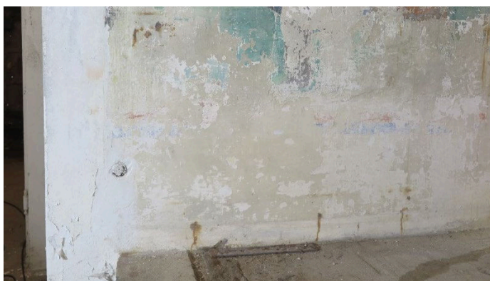
Fig. 5. Sydvæg, limfarvede bånd 44 cm over gulv.
