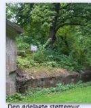
Den ødelagte støttemur
