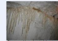
Grov revne i betonkonstruktionen
