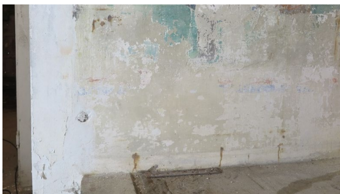
Fig. 5. Sydvæg, limfarvede bånd 44 cm over gulv.
