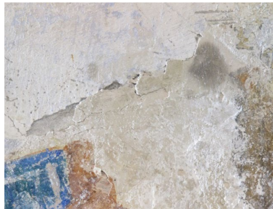
Fig. 17. Sydvæg, op- og afskallet malepuds.
