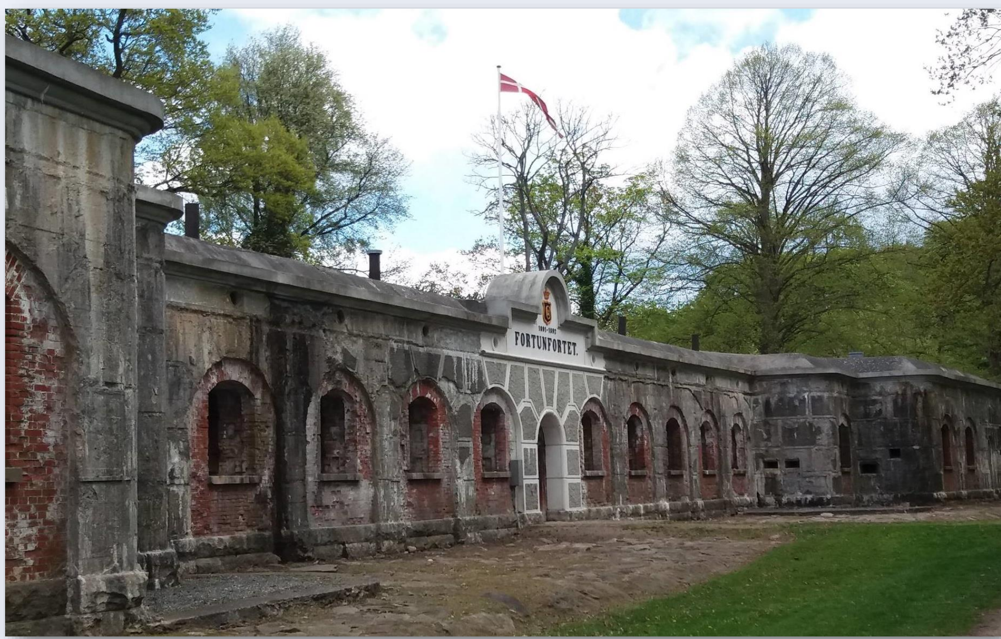
Fortunfortets ødelagte facade
