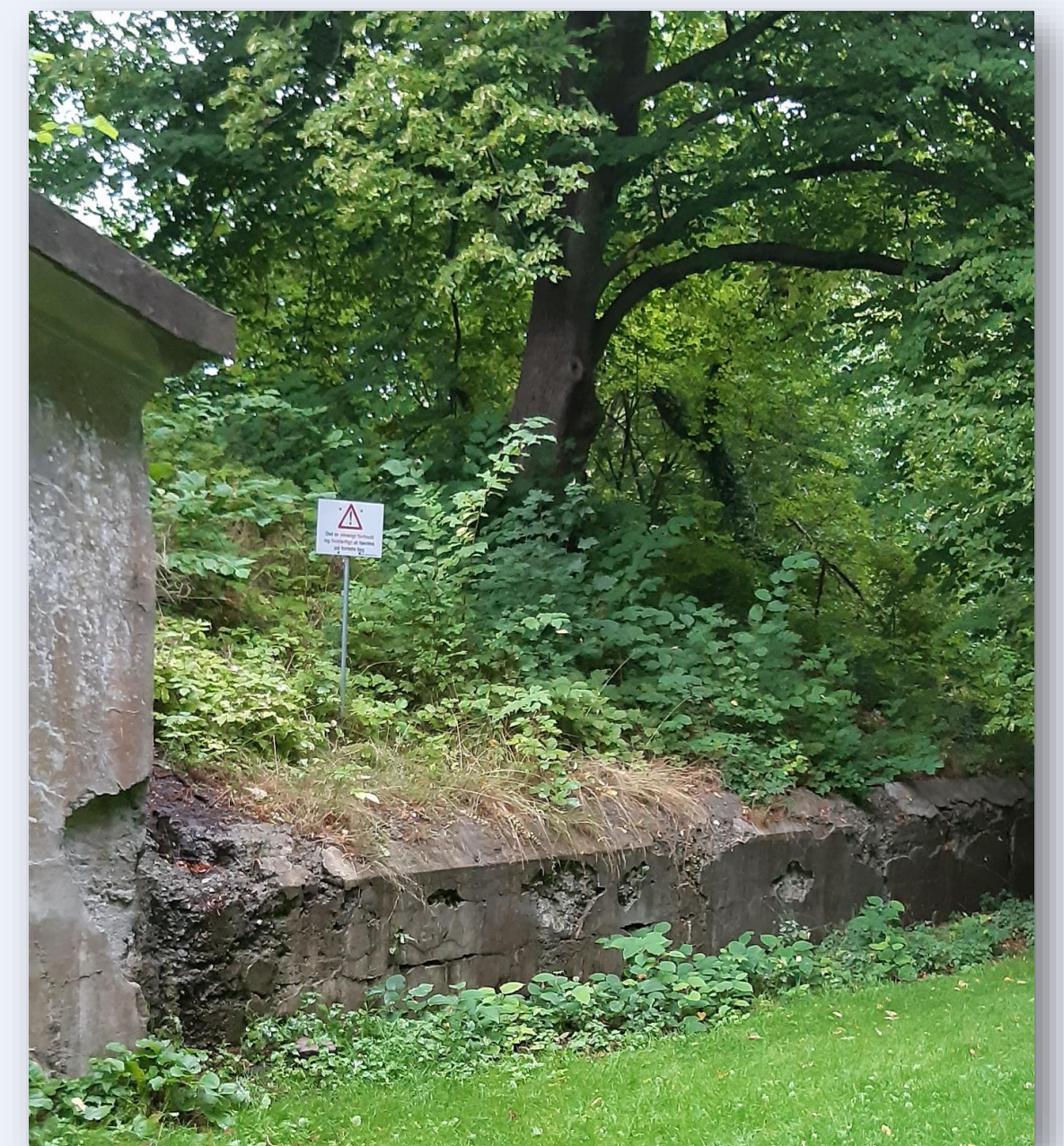
Den ødelagte støttemur
