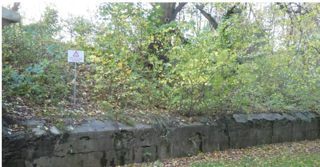
Udsnit den ødelagte støttemur
