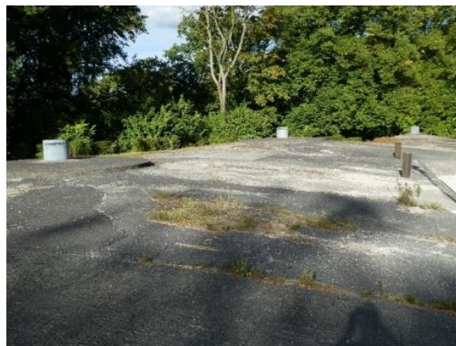
Det ødelagte betontag
